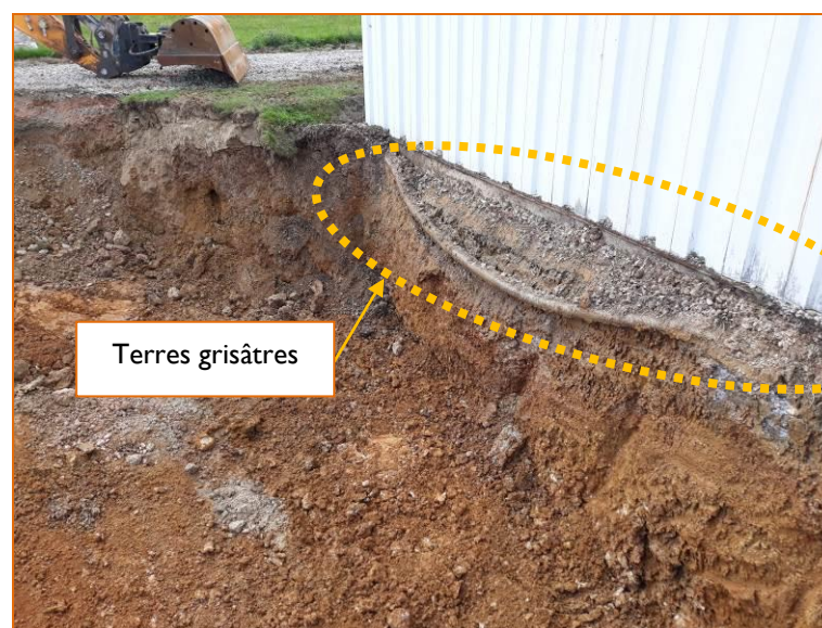
Figure 8 : Terre grisâtre sur paroi nord-ouest
