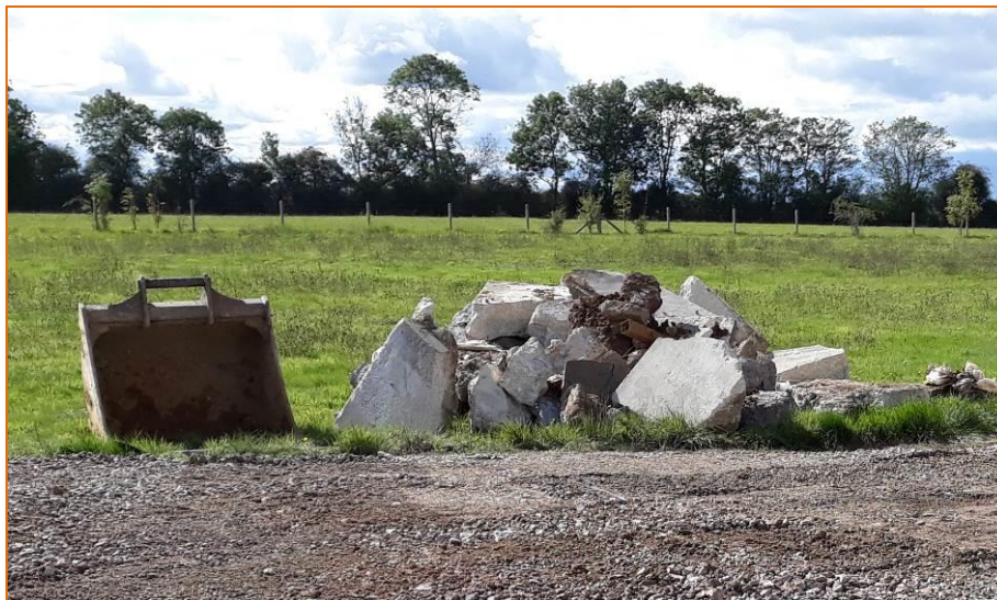
Figure 5 : Débris béton issus de la dalle en attente d'évacuation
